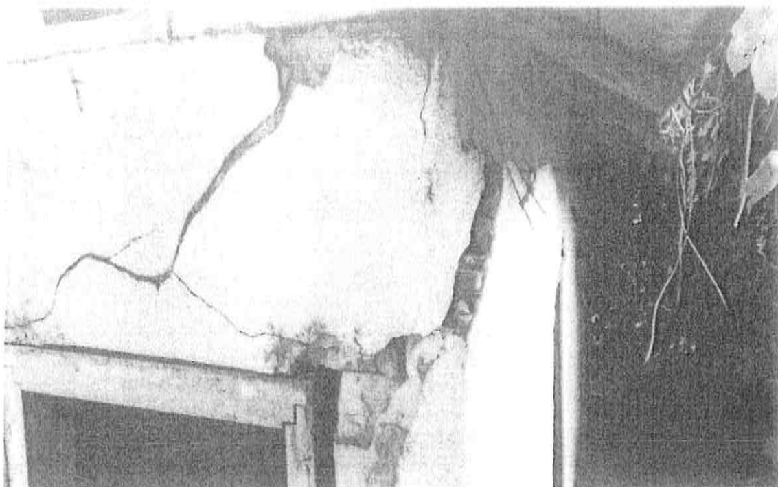
Fisuri și dislocări corp C5
