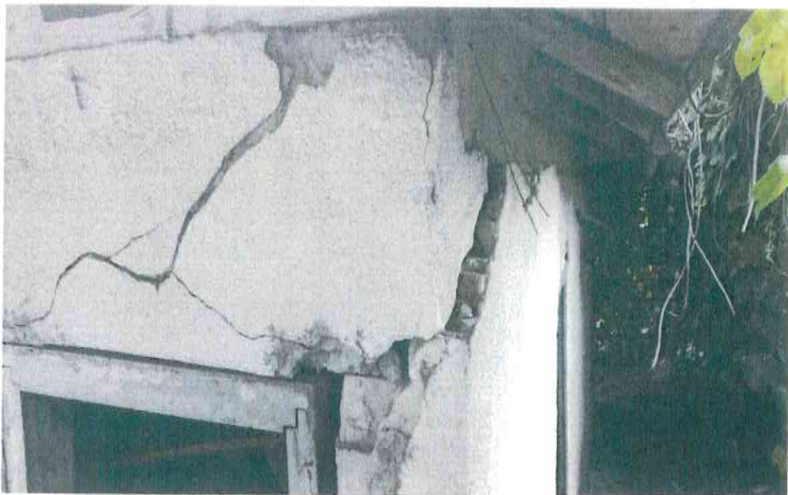
Fisuri și dislocări corp C5
