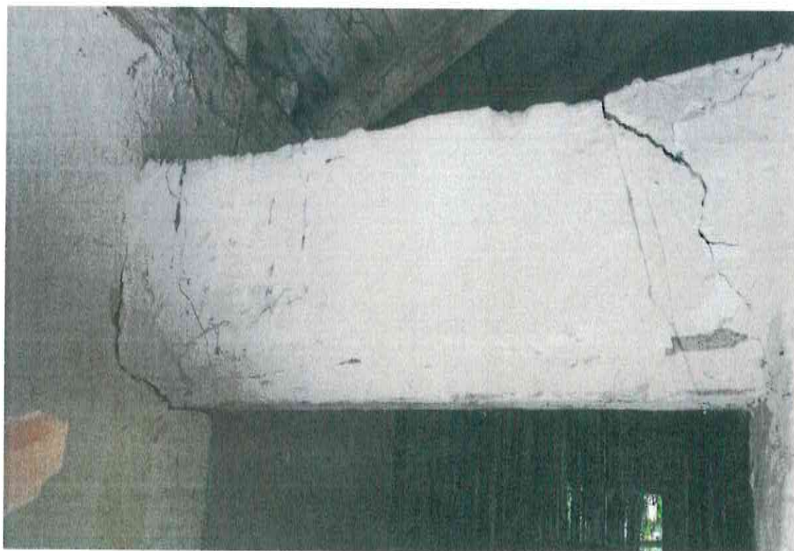
Fisuri corp C5
