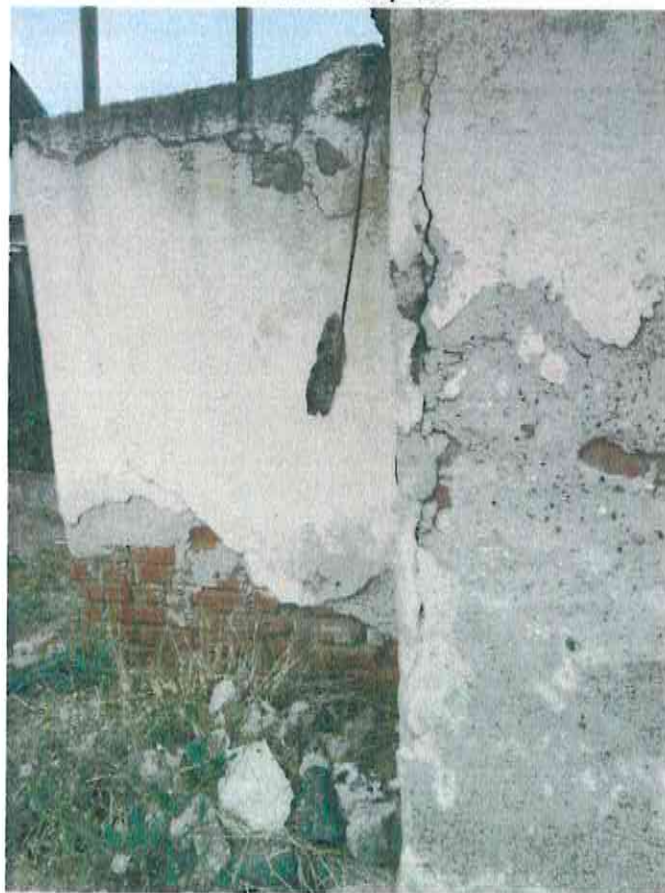
Fisuri corp C3
